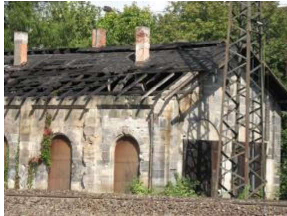
Verfällt weiter: Der historische Lokschuppen an der Stadtgrenze
