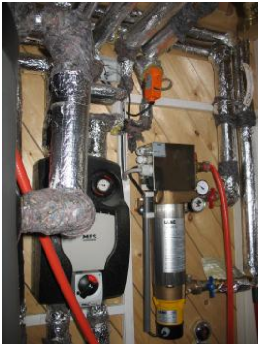
Eine effektive Energieverwertung benötigt viel Steuerung und Elektronik. Impression aus dem Hauswirtschaftsraum.
