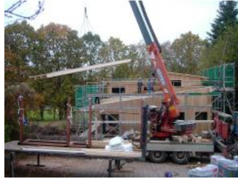
Montage der „Hülle“ aus Fertigteilen. Die Zusammenarbeit mit Zimmerleuten ist lehrreich, aber rau...
